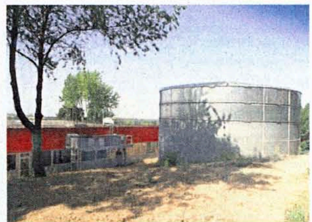
Das haus eigene Wasserreservoir für die Spinkleranlagen in den Hallen am Höseler Platz.
